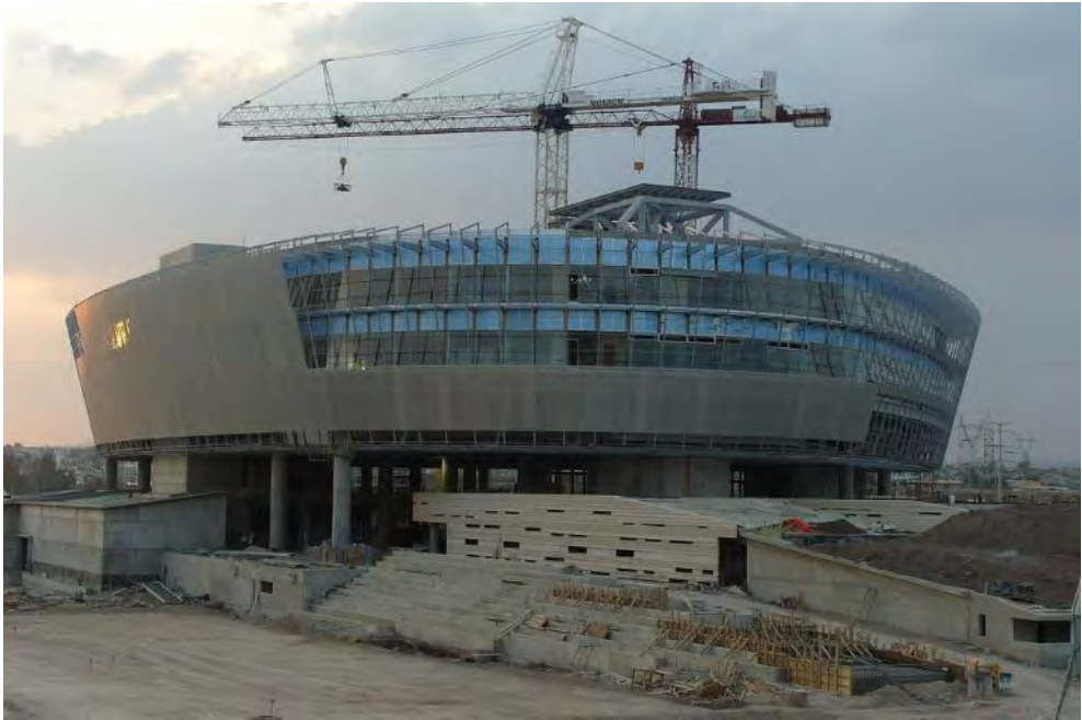
Proyecto del Call-center de Querétaro, presupuestado por Varela y cuya Ingeniería de valor resultó en un ahorro de 4.5 millones de USD.
