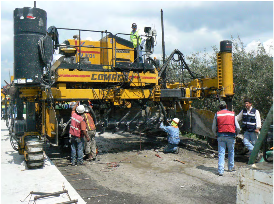
Pavimentación en concreto rígido en la carretera México-Querétaro, verificación de rendimientos por parte del autor
